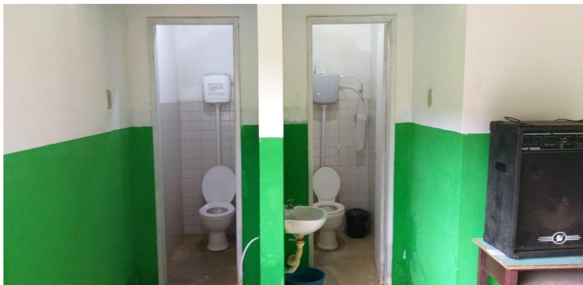
Figura 02 - Apenas 02 banheiros na escola Lagoa Dantas (compartilhamento dos alunos com os funcionários; pia com vazamento)
