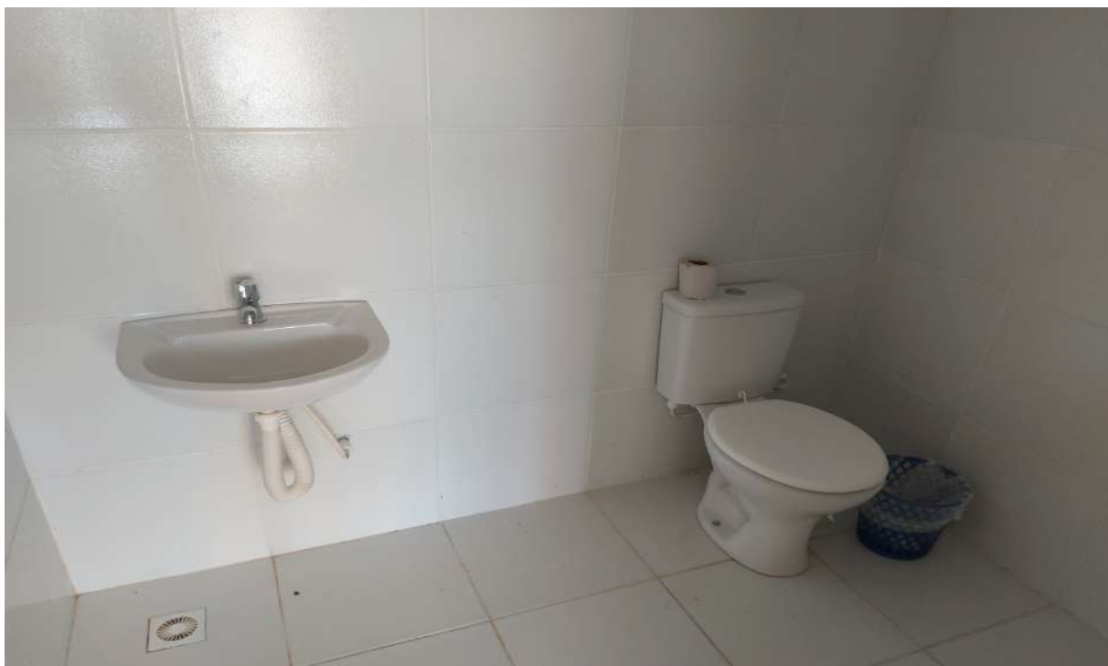
Escola Tertulina Rafael de Siqueira - Ausência de descarga funcionando.
