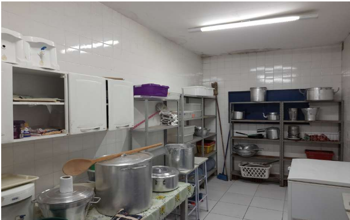
Escola Municipal Luiz Epaminondas Filho - goteira no teto.
