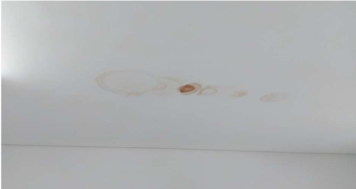
Escola Municipal Anfilóbio Feitosa - goteira no teto.
