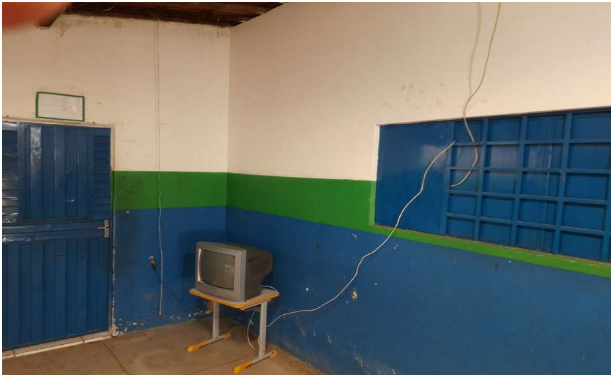
Escola Municipal Luiz Epaminondas Filho - fiação exposta
