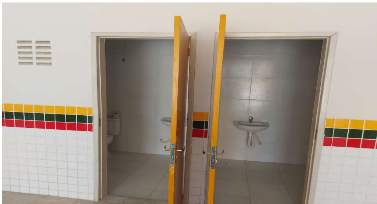
Escola Tertulina Rafael de Siqueira - Ausência de banheiro exclusivo
