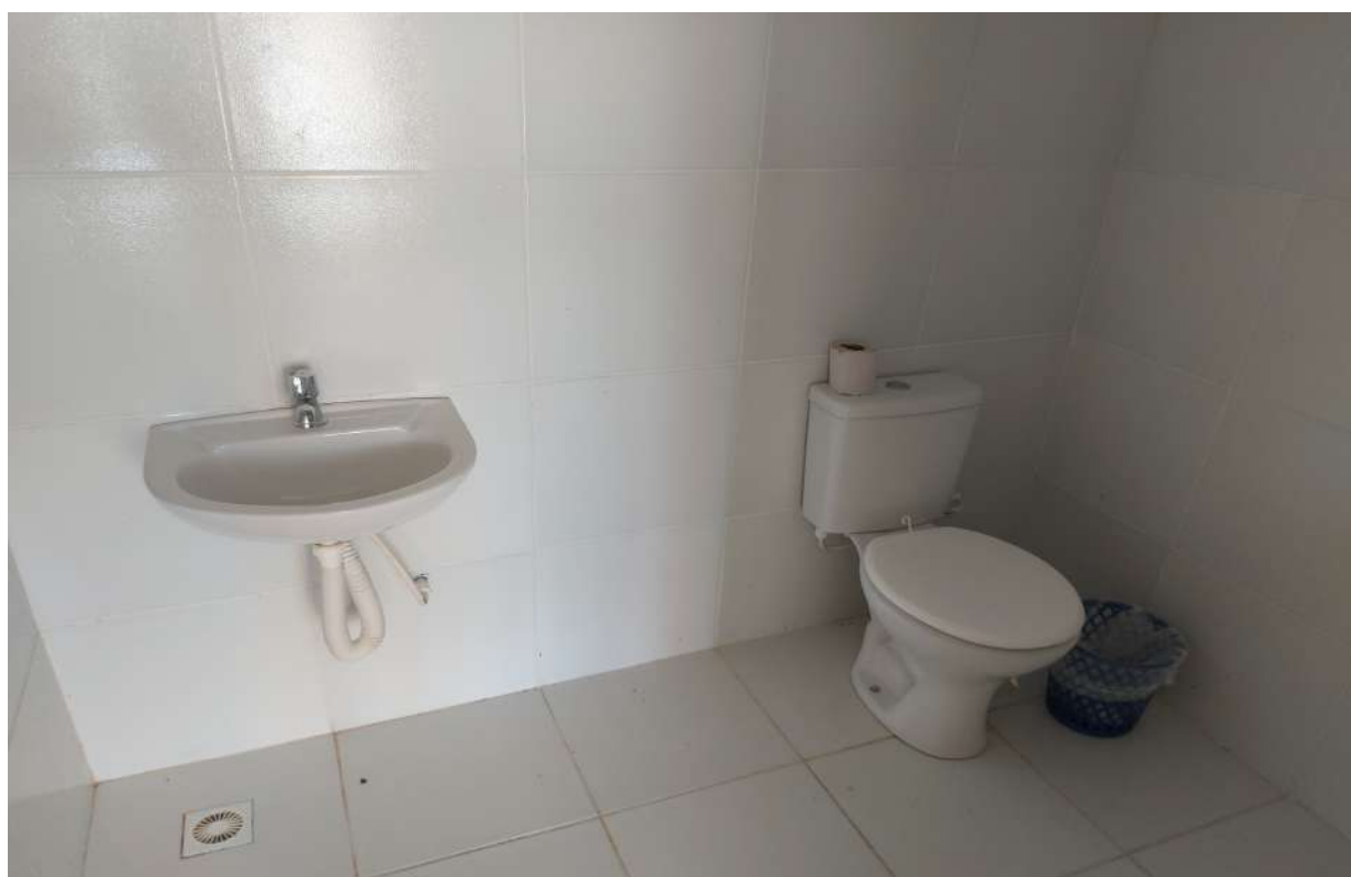
Escola Tertulina Rafael de Siqueira - Ausência de banheiro masculino e feminino.
