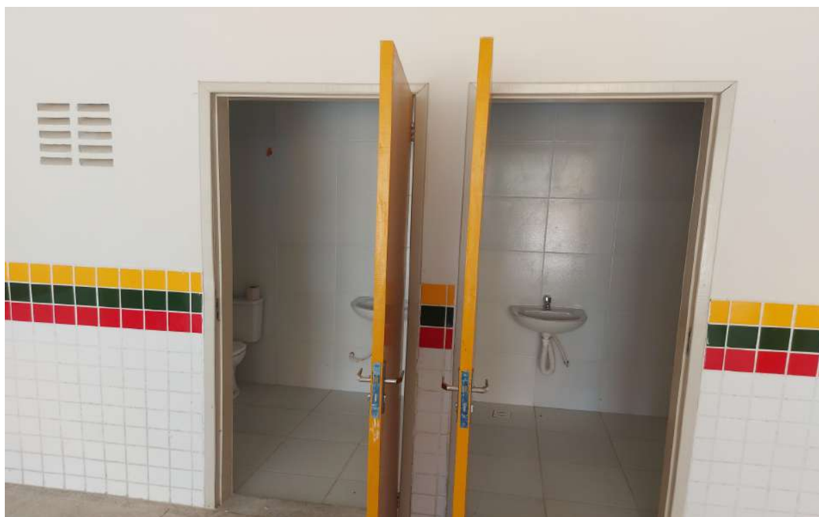
Escola Tertulina Rafael de Siqueira - Cabines internas sem condições de uso.
