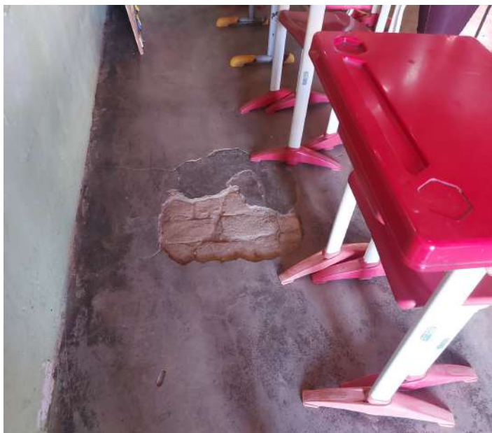
Figura 04 - Escola Porfírio Gomes de Souza - presença de fissuras (rachaduras) no piso.
