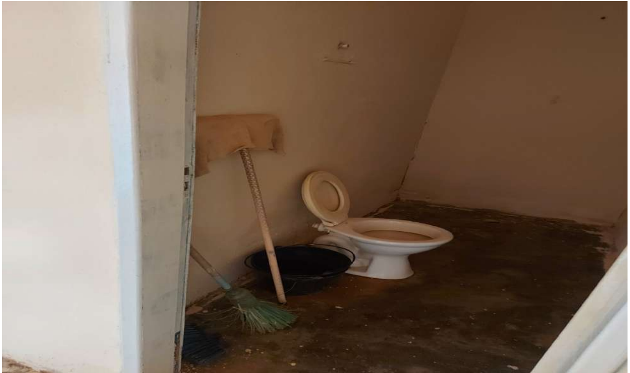
Escola João Antônio Nogueira - ausência de pias nos banheiro
