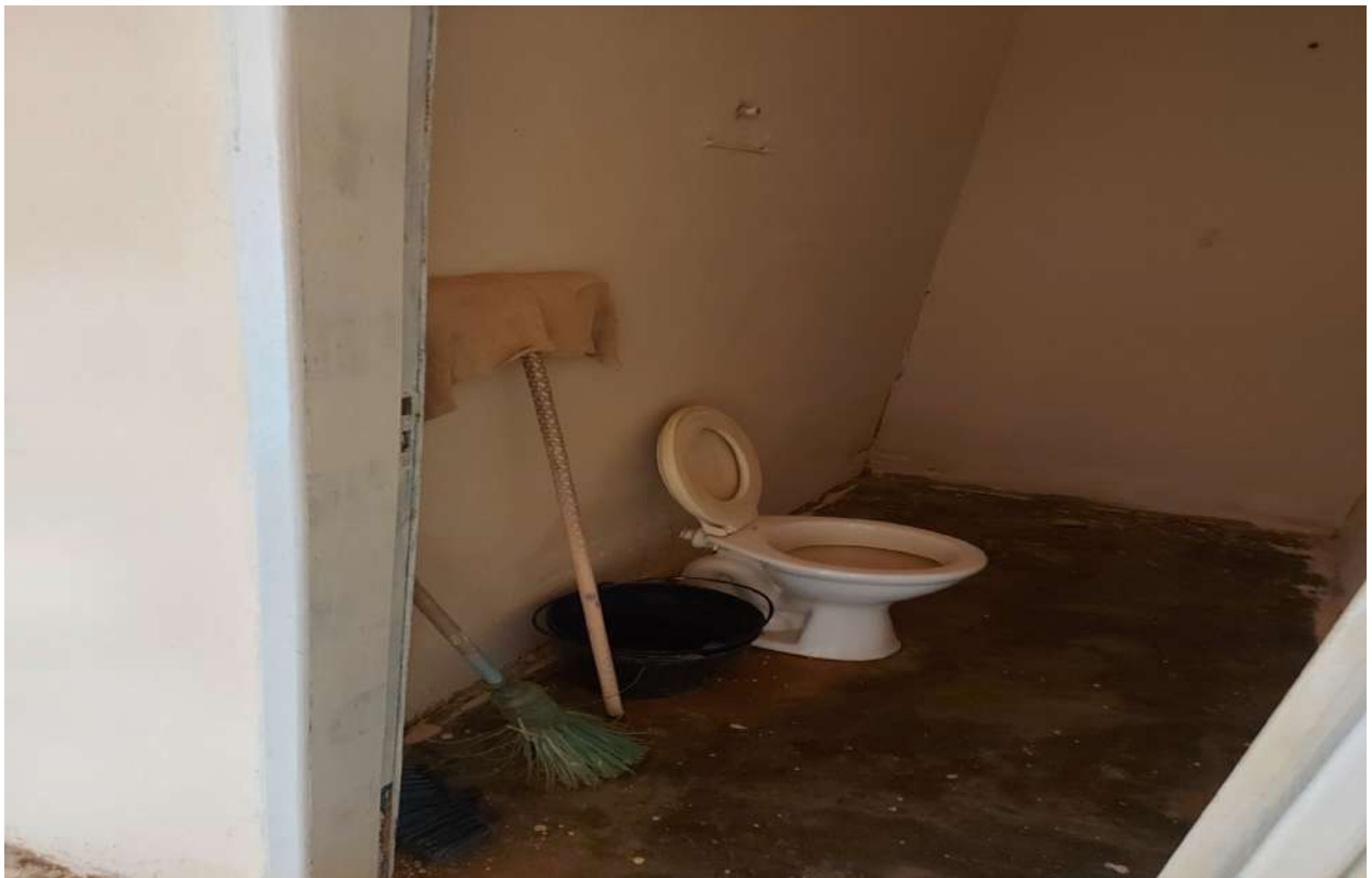
Escola João Antônio Nogueira - porta do banheiro sem condições de uso.
