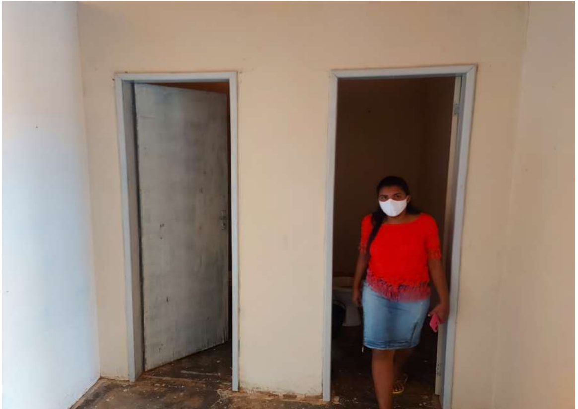
Escola João Antônio Nogueira - banheiro não adaptado para cadeirantes.
