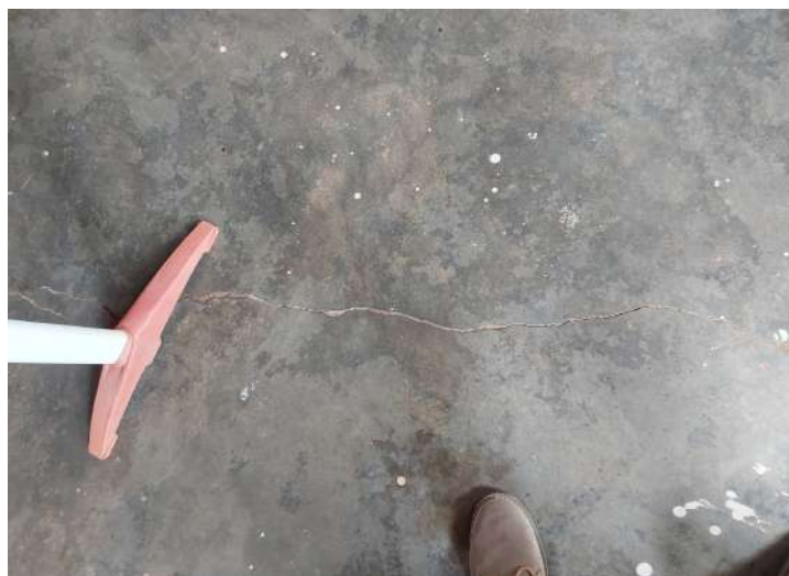
Figura 06 - Escola Antônio Primo de Carvalho - presença de fissuras (rachaduras) no piso
