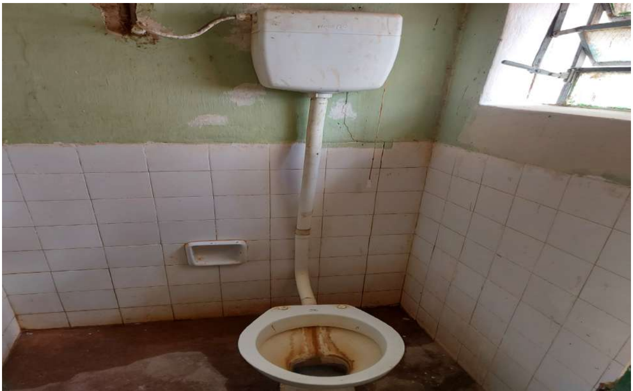
Escola Antônio Primo de Souza - banheiro sem bacias sanitárias, sem acento e sem descarga.
