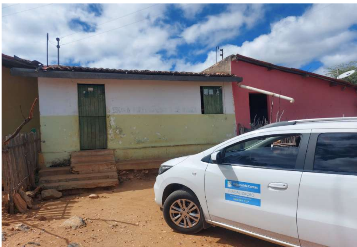
Escola Porfirio Gomes de Souza - ausência de rampa de acesso.
