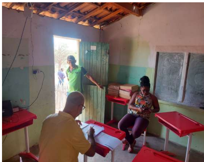
Figura 03 - Escola Porfírio Gomes de Souza - infiltrações nas paredes das salas de aula.
