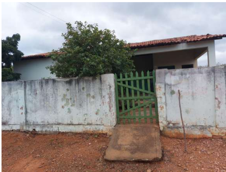
Figura 01- Risco de Queda de Telhas na Escola André Alves da Silva
