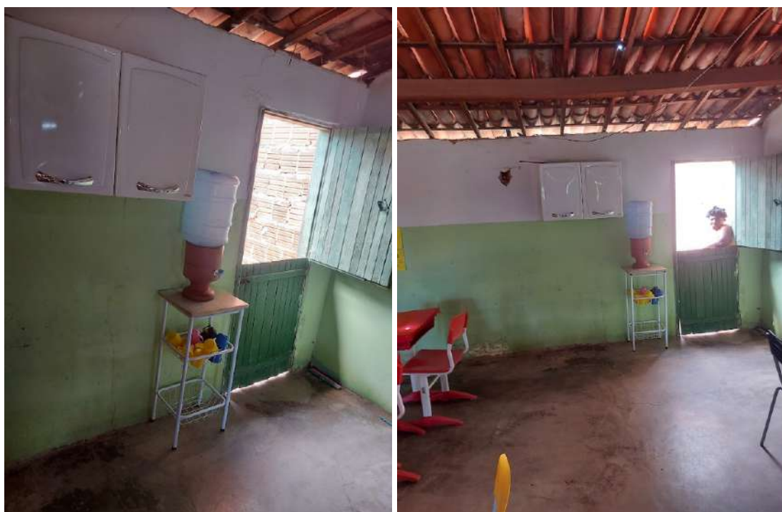
Escola Porfírio Gomes de Souza - ausência de local adequado para acondicionamento dos gêneros.
