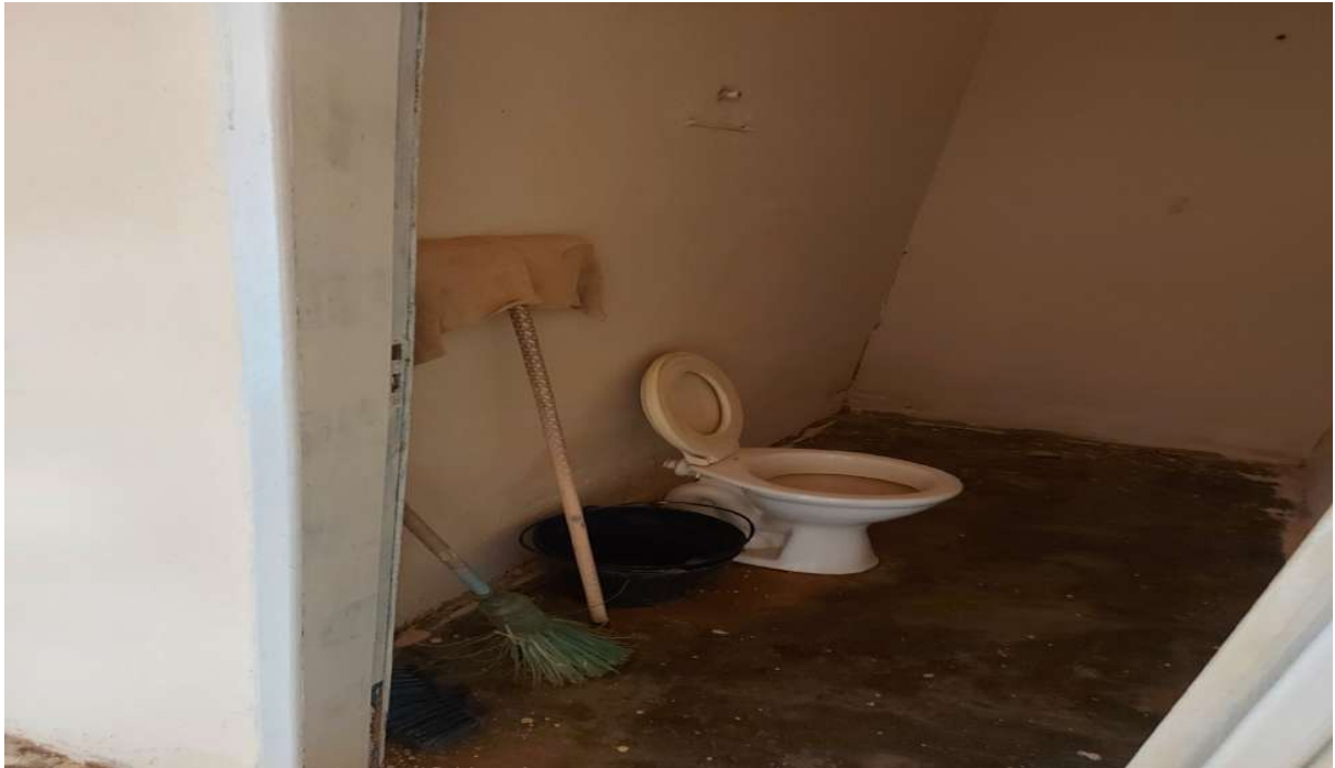
Escola João Antônio Nogueira - banheiro sem bacias sanitárias, sem acento e sem descarga.
