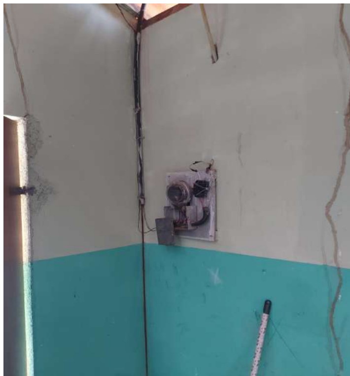
Figura 02- Detalhe de fiação exposta na Escola Cecília Meireles
