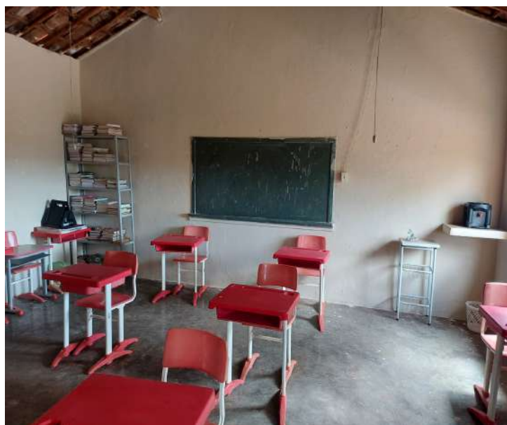
Figura 07 - Escola Antônio Primo Carvalho - lousa sem condições de uso.
