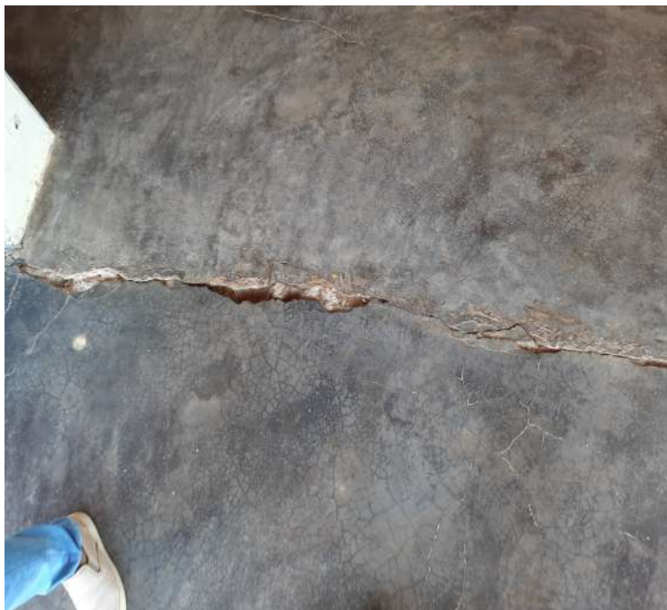
Figura 04- Detalhe das fissuras (rachadura) na Escola Padre Bette
