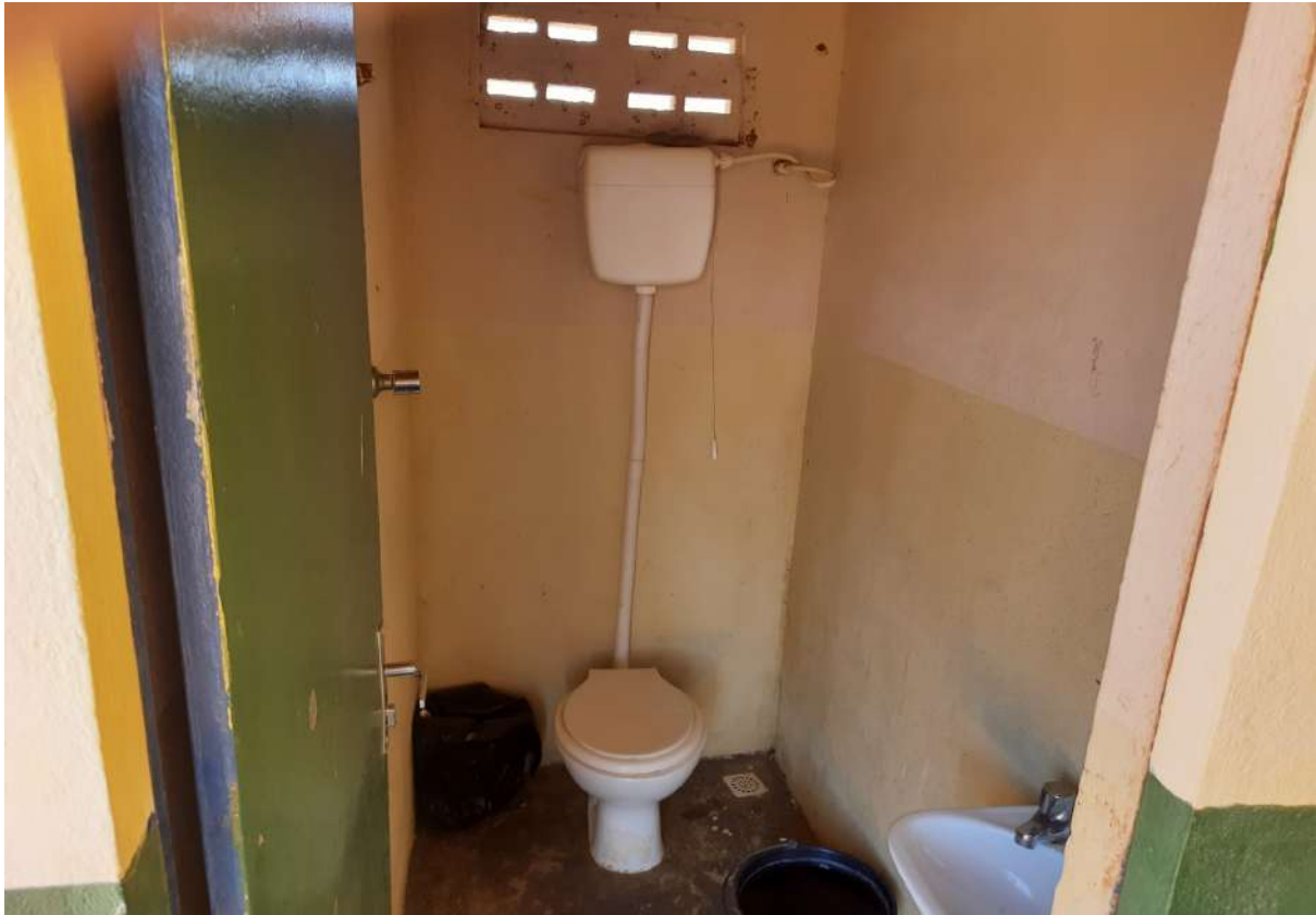
Escola Júlio Bernardo (ausência de banheiros adaptados a cadeirantes)
