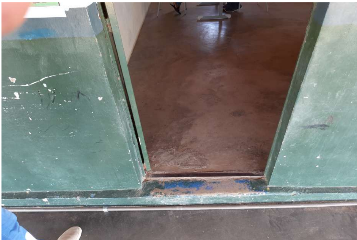
Escola Francisco Lopes (ausência de rampa de acesso)
