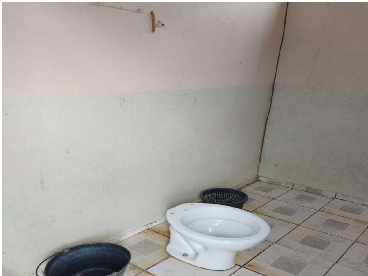
Escola Municipal do Jaburu (ausência de descarga funcionando)
