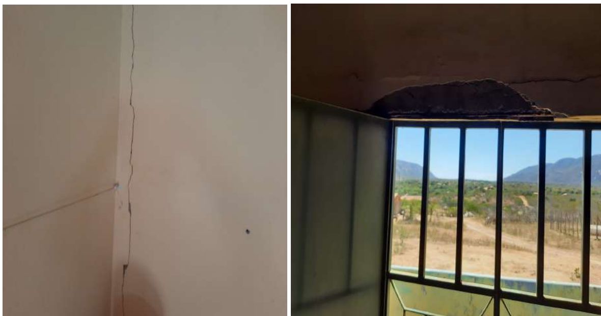
Figura 01- Infiltrações e rachaduras na Escola Francisco Lopes
