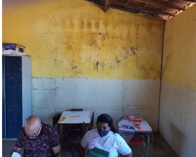
Figura 02- Infiltrações e rachaduras na Escola Júlio Bernardo
