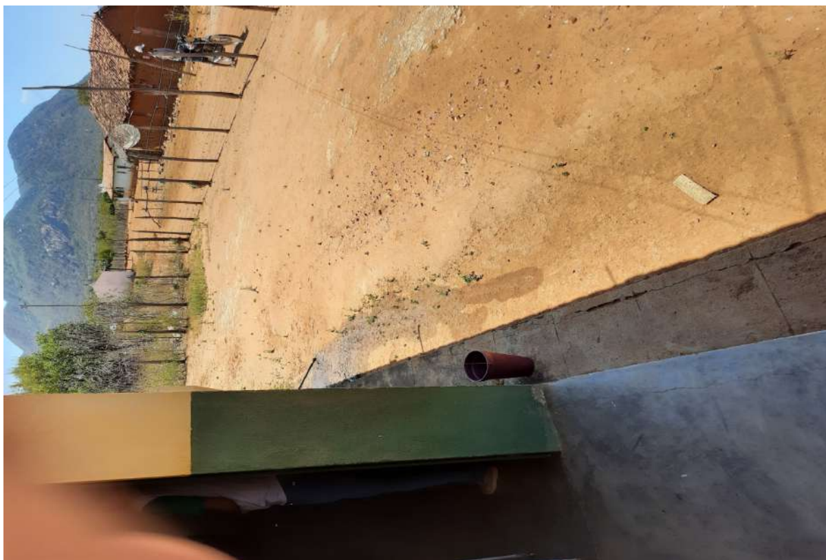
Escola Júlio Bernardo (ausência de rampa de acesso)
