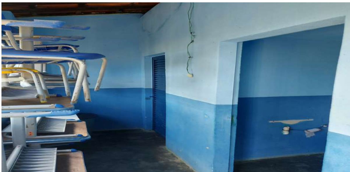
Escola Dom Bosco (Ausência de pia no banheiro)
