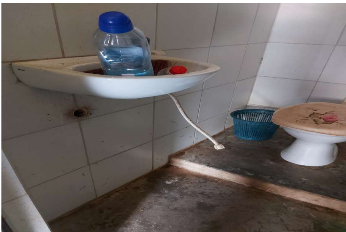
Escola Dr. Antônio Geraldo Guedes (Pia do banheiro sem funcionar)
