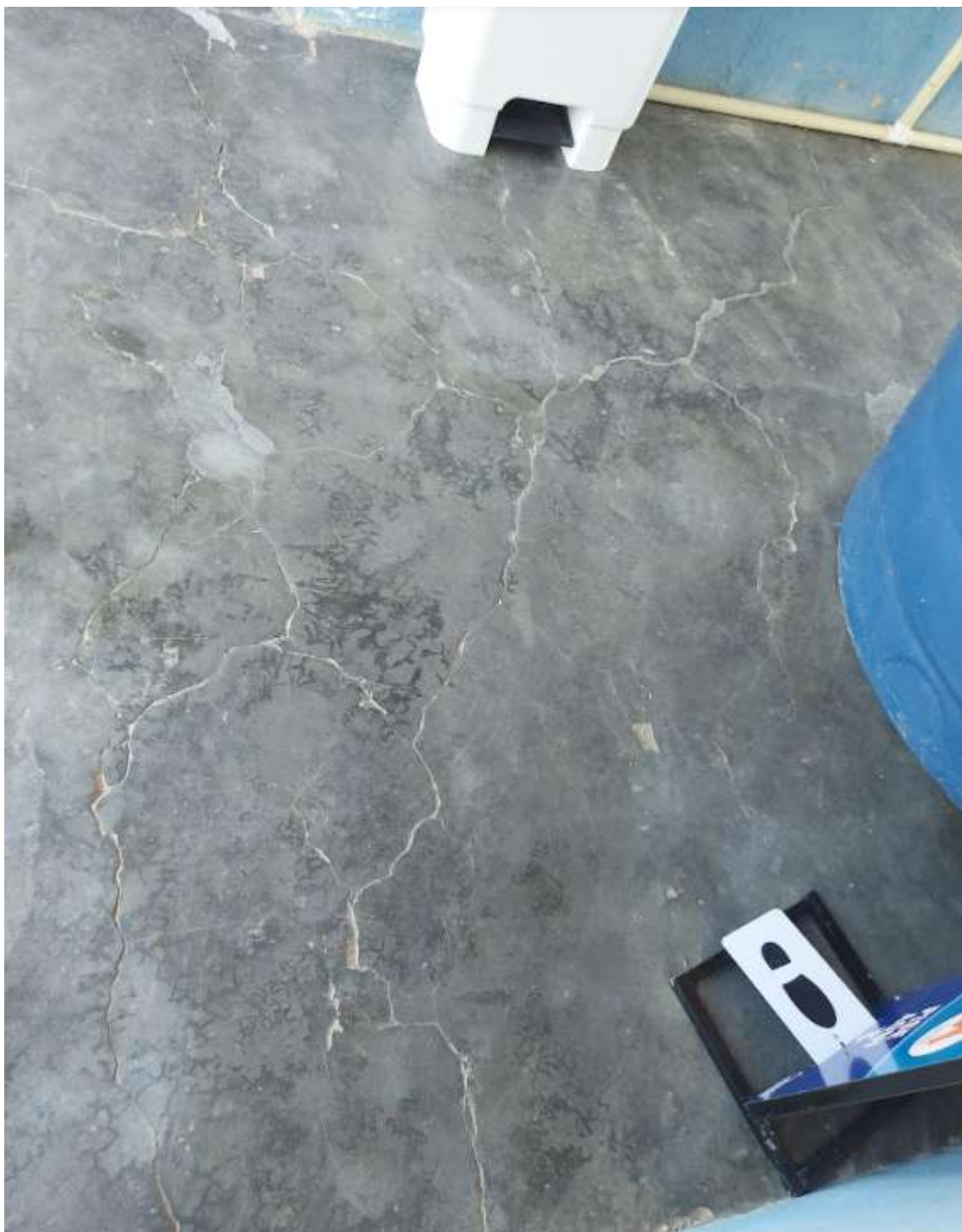
Figura 03 - Fissuras no piso na Escola Dom Bosco
