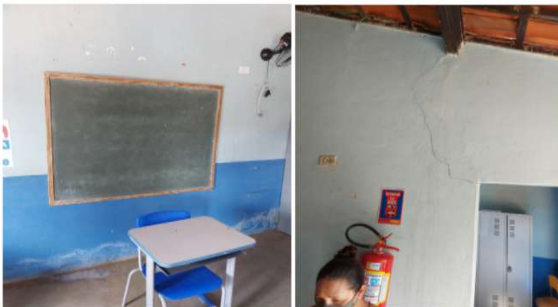
Figura 01 - Infiltrações, fissuras e lousas sem condições de uso na Escola Sete de Setembro
