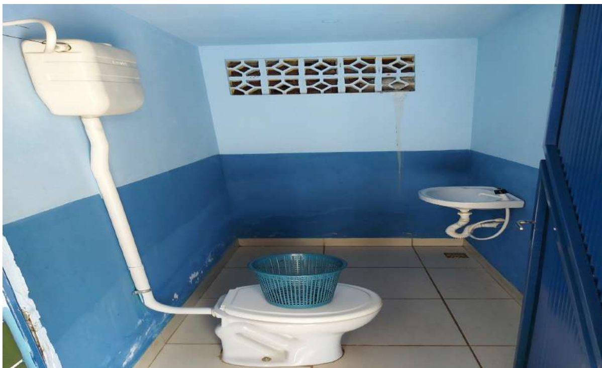
Escola Luis José do Nascimento (Pia do banheiro sem funcionar)
