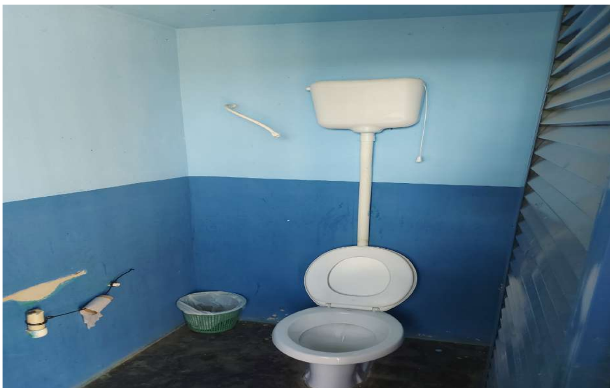
Escola Dom Bosco (Ausência de bacias sanitárias com descarga funcionando)
