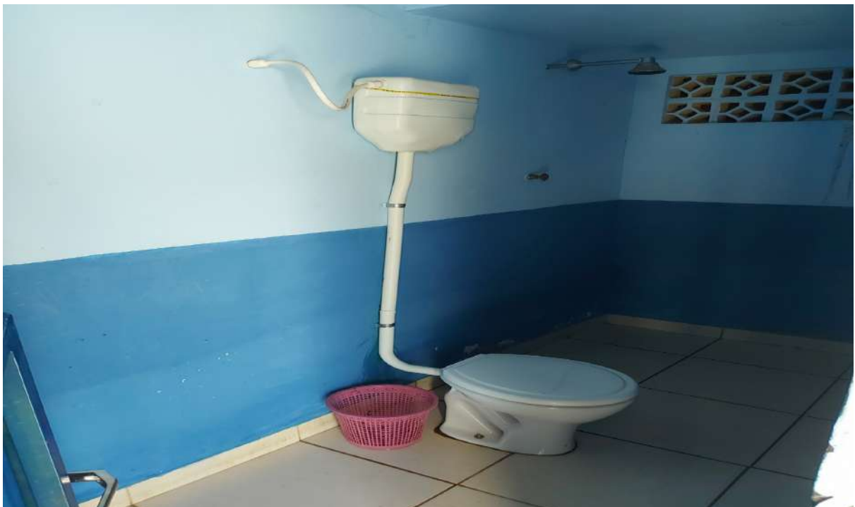
Escola Luis José do Nascimento (Ausência de bacias sanitárias com descarga funcionando)
