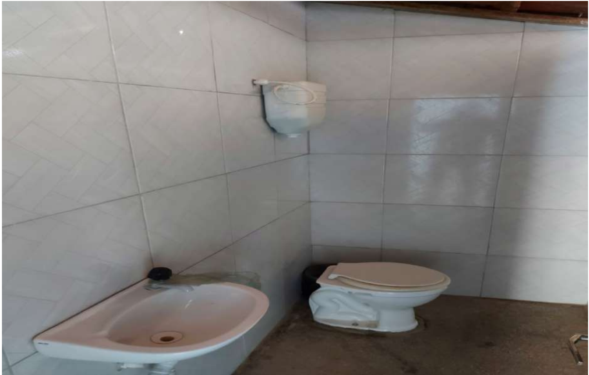
Escola Joaquim José de Santana (Ausência de bacias sanitárias com descarga funcionando)
