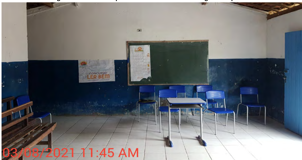
Imagem 3 - Ausência de pia nas áreas comuns da EM Engenho Capivarinha
