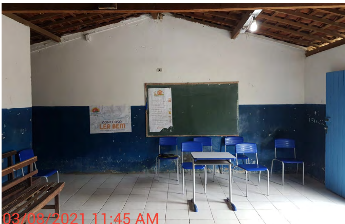
Umidade excessiva e pintura deteriorada
