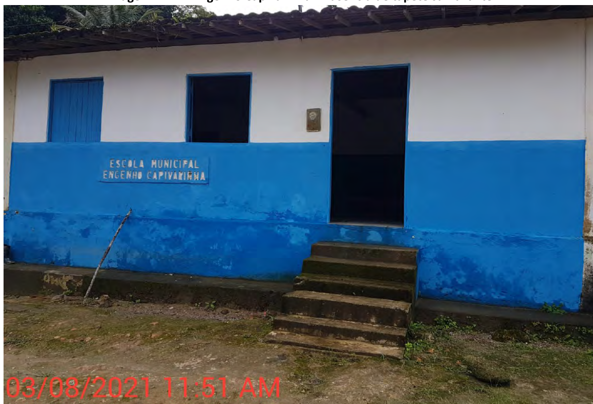
Imagem 1 - EM Engenho Capivarinha - Ausência de tapete sanitizante
