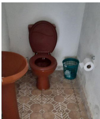
Figura 2: Banheiro da Escola Otacílio Carlos de Alencar.
