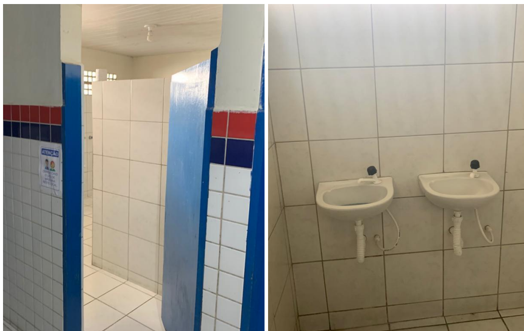
Banheiros da Escola Paulo Cordeiro de Farias sem adaptação para cadeirantes.
