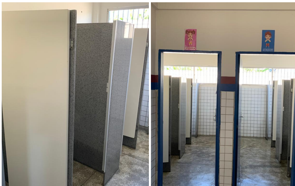
Banheiros da Escola Carlos Rios sem adaptação para cadeirantes.
