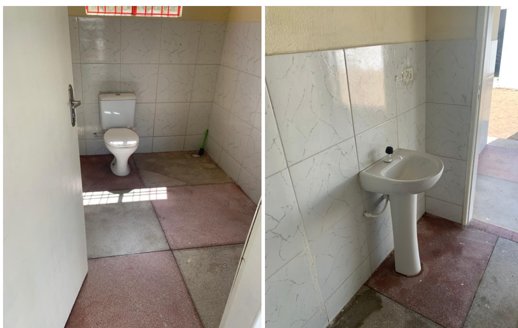
Banheiros na Escola Eurico Souza Leão sem adaptação para deficiente físico
